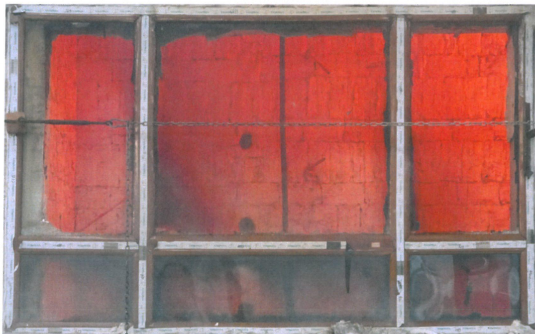
照片二 试验结束时试件情况
